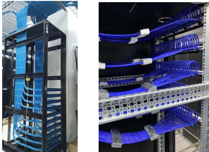
图3 综合布线系统机柜内理线工艺
