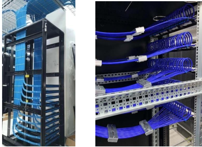
图3 综合布线系统机柜内理线工艺
